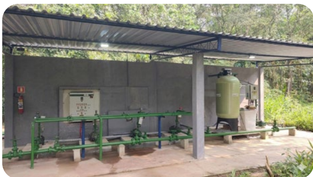
Casa de bombas
