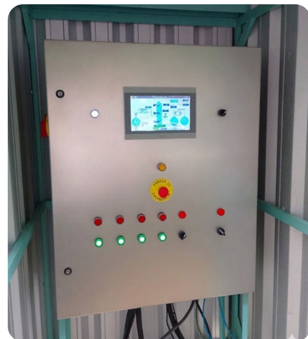
Painel de controle da torre de acetona do RDX
